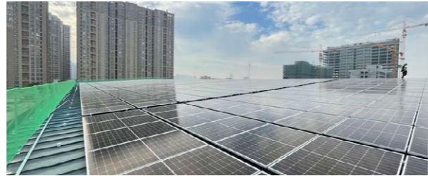
华润五丰下沙冷食工厂光伏项目
